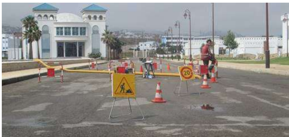
Figure 181. Exemple de zone de travaux à M'diq : agent signalé et zone de travaux bien délimitée. Source : photo CID
