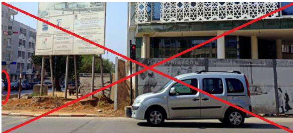
Figure 179. Exemple de chantier empiétant sur le trottoir sans aucune mesure de sécurité pour piétons : pas d'espace minimale respecté, pas de trottoir provisoire, pas de passage piétons qui renvoie à l'autre côté de la rue. Sur le côté on entrevoit un piéton marchant sur la chaussée. Source : Photo Rabat.
