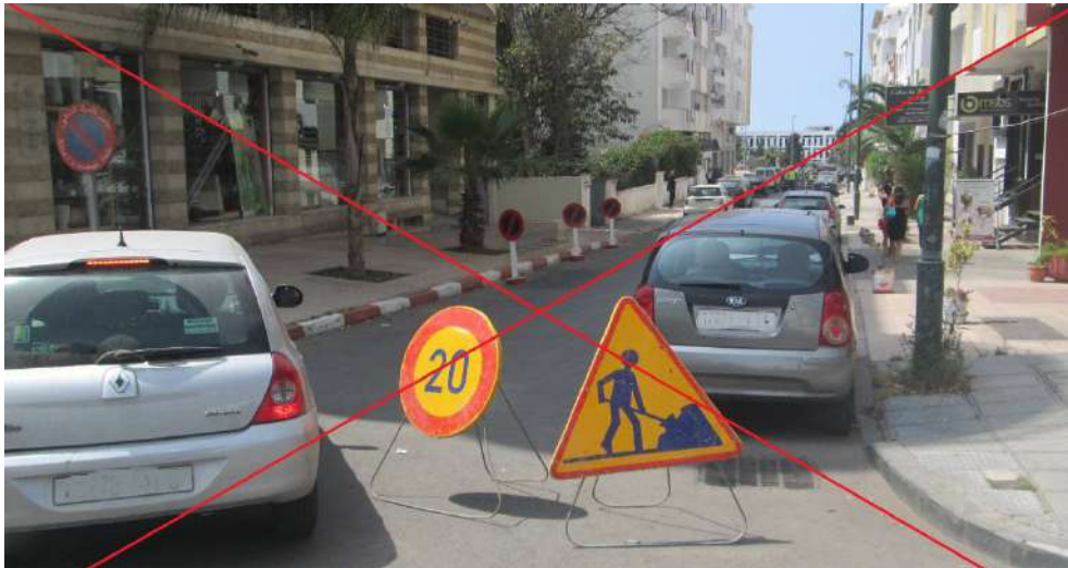
Figure 180. Signalisation temporaire dans une voie de quartier à Rabat. Le panneau indiquant le type de situation pour la circulation (par ex. rétrécissement de la voie) est absent : le conducteur ne sait pas à quoi s'attendre. Source : Photo CID.
